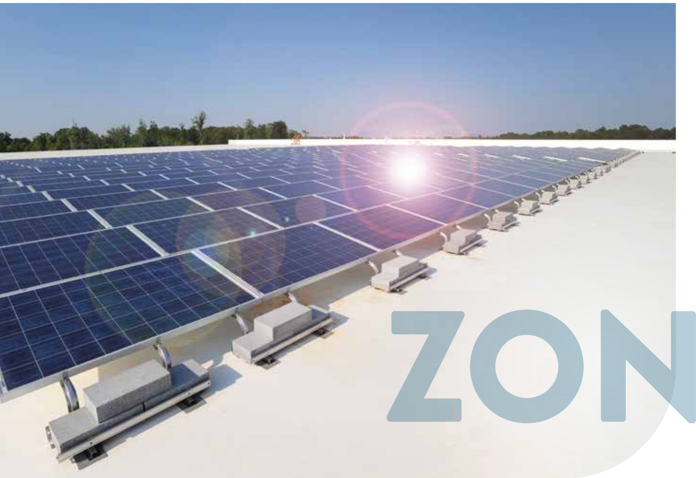
Zonnepanelen op alle magazijnen
